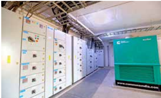
Actual View of DG Room
