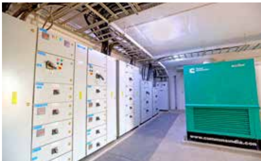
Actual View of DG Room
