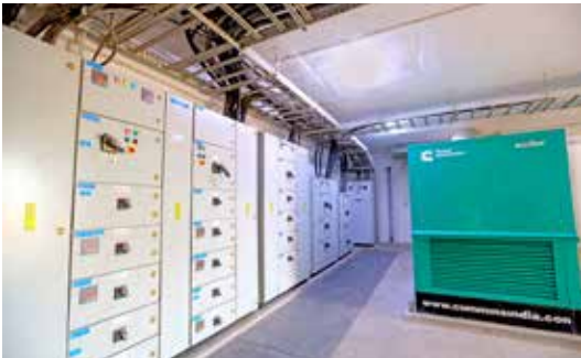
Actual View of DG Room
